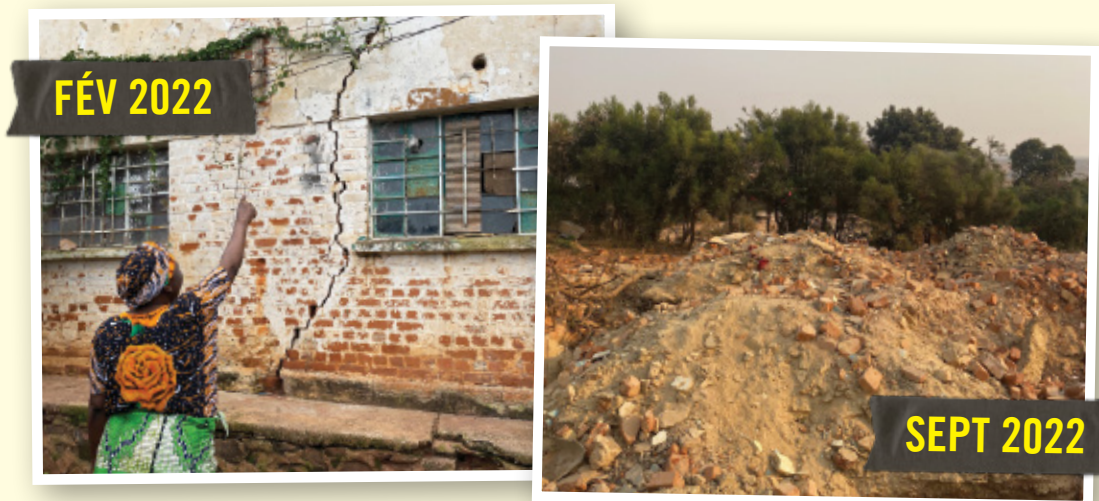
↑ Cécile Isaka montrant une fissure dans sa maison provoquée par les activités de la mine de cuivre et de cobalt exploitée par COMMUS, février 2022 (à gauche) ; ruines de la maison de Cécile Isaka, septembre 2022 (à droite). © Amnesty International (photo : Jean-Mobert Senga)
